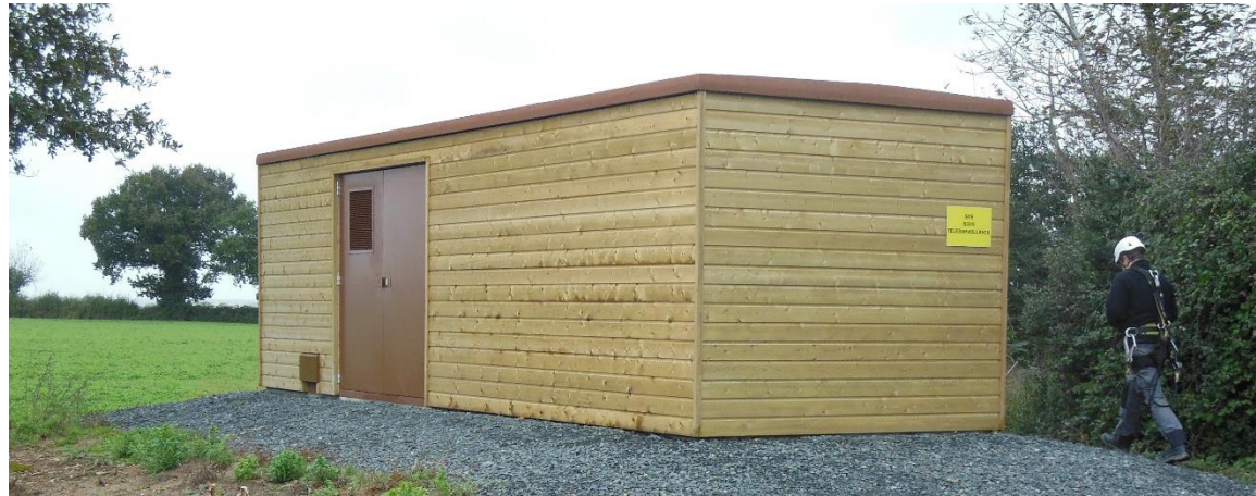
Figure 10 : Illustration du poste de livraison bardage bois (source : EPURON, 2014)
